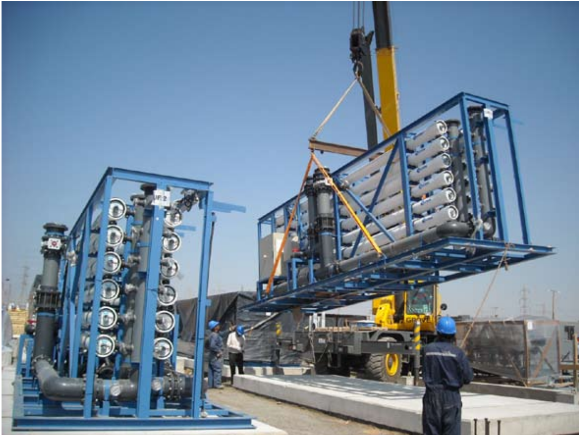
Instalando nuestros equipos de desalinización de agua de mar en el desierto de Atacama (Chile). 2010.
