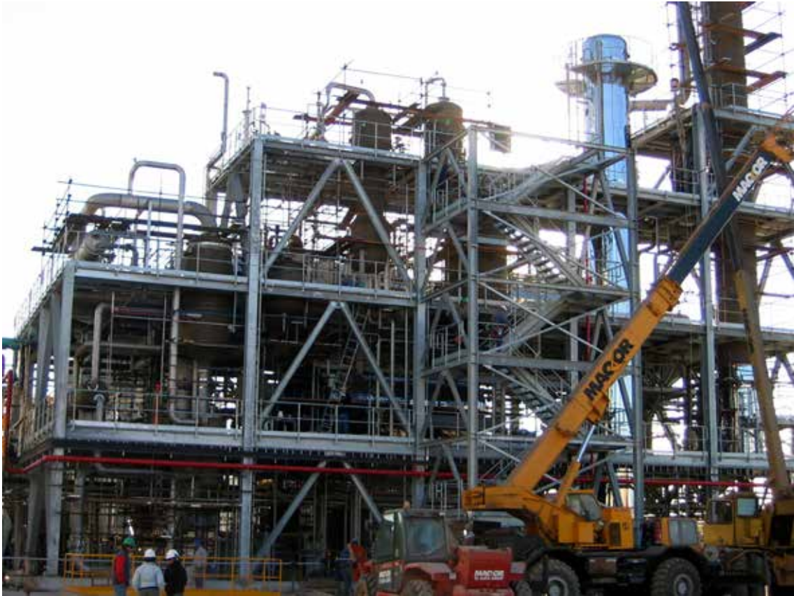
Obra de ingeniería: primer planta de Biodiesel de proceso continuo.
