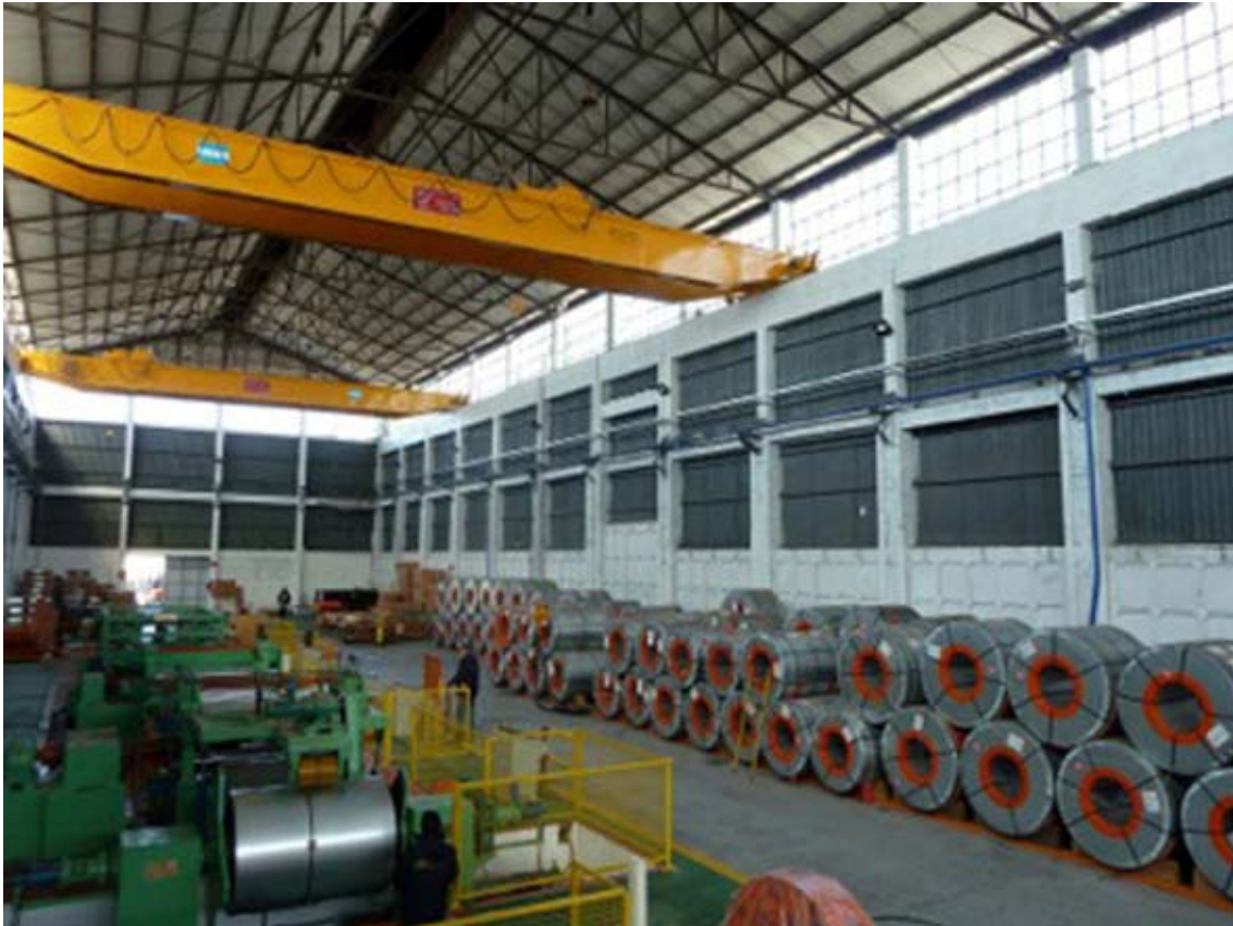
Interior de la planta de Fumiscor.
