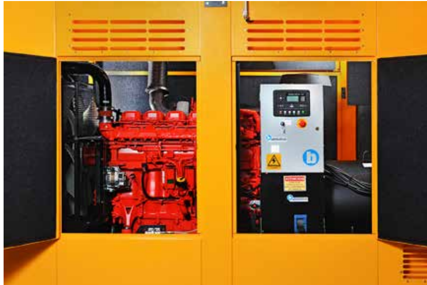
Grupo electrógeno de 500 KVA.
