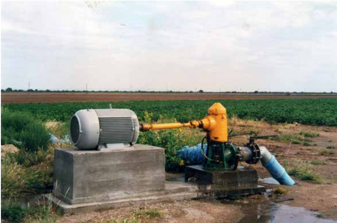
Bomba con motor eléctrico.
